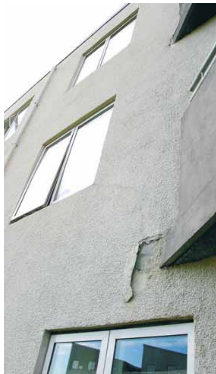
Áður en tilboð er gert í fasteign er nauðsynlegt að láta meta húsið bæði að utan sem innan. Sérstaklega eldri hús og hús sem byggð eru á alkalí-tímanum.
