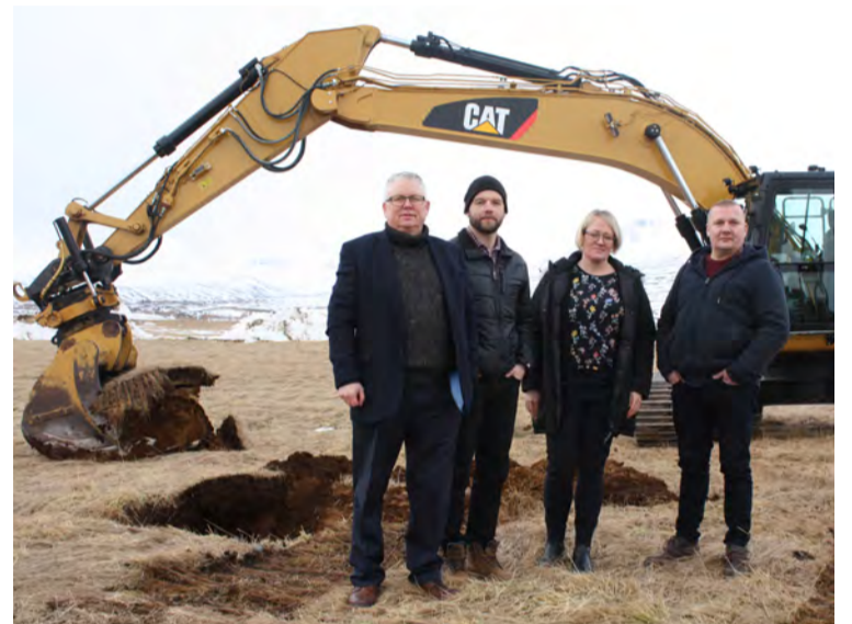
Framkvæmdir eru hafnar við nýtt íbúðarsvæði í þéttbýlinu við Lónsbakka í Hörgársveit. Fyrsta skóflustunga var tekin á dögunum, en frá vinstri eru Snorri Finnlaugsson sveitarstjóri, Axel Grettisson oddviti, María Albina Tryggvadóttir og Jón Þór Benediktsson, sem sæti eiga í sveitarstjórn. Mynd / MPP
