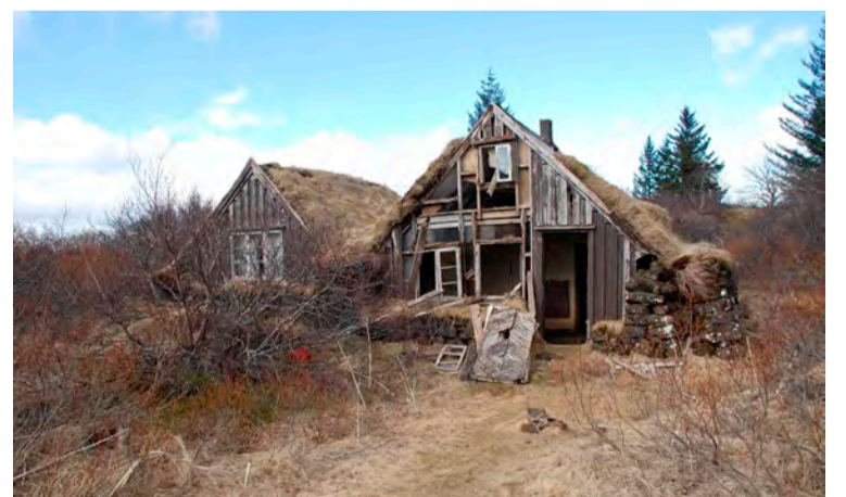
Suðurhlið Laxabakka vorið 2017. Enn hefur hallað á ógæfuhlið hússins og í nýlegu óveðri hrundi strompurinn.
