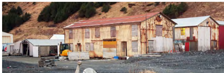
Eins og sjá má þá er húsið Halldórsbúð í Vík mjög illa farið en samt á að fara að endurbyggja húsið sem hefur staðið á Víkursandi í 118 ár. Mynd / Orlygur Karlsson
