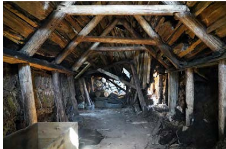
Ástand Kotbýlisins fyrir viðgerðir. Þakið var hrunið að hluta og trégrind hafði skekkt vegna snjóþyngsla.
