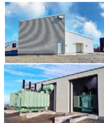
Nýja aðveitustöð RARIK á Sauðárkróki og nýir aflspennar teknir í hús.
