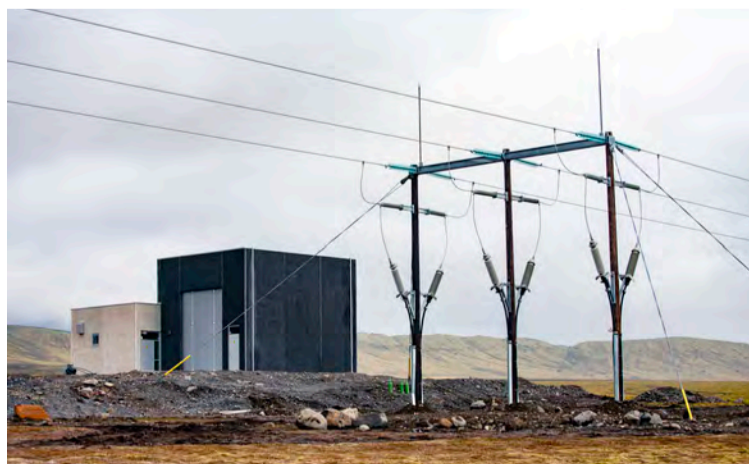
Nýtt tengivirki Landsnets og aðveitustöð RARIK eru undir Kvíaröllu austan við bæinn Hnappavelli. Þessi staðsetning telst trygg en hún var meðal annars valin með tilliti til hugsanlegra jökulflóða.
