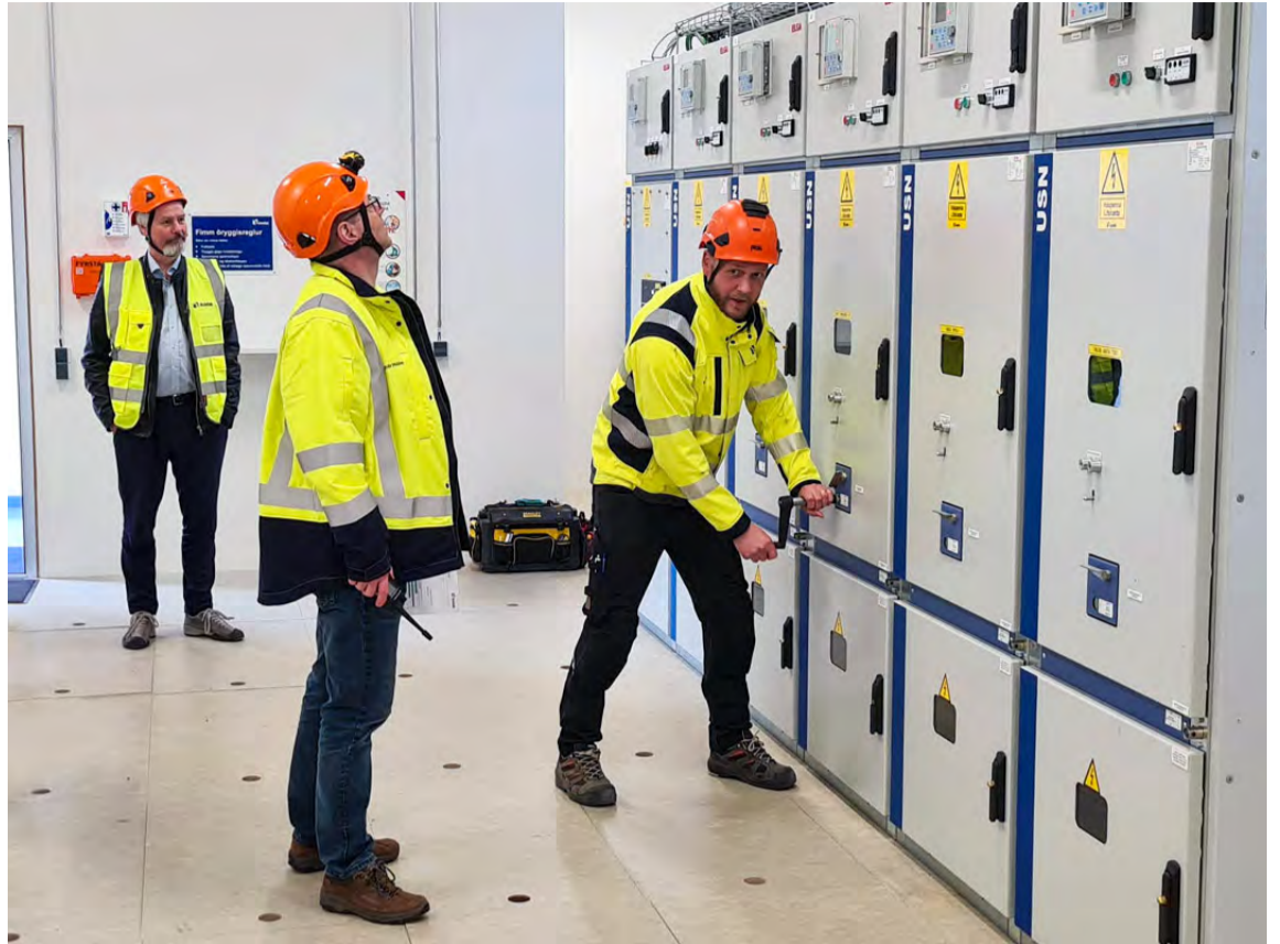
Starfsmenn RARIK undirbúa spennusetningu aðveitustöðvarinnar.
