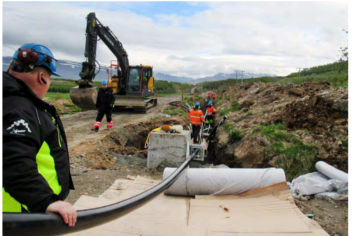
Framkvæmdir við Hólasandslínu 3 sem tengir Akureyri við Hólasand standa nú yfir og ganga vel. Um þessar mundir er verið að leggja um 10 kílómetra jarðstreng milli Akureyrar og Kaupangs í Eyjafjarðarsveit. Hólasandslínan er 220 kV háspennulína í meginflutningskerfinu á Norðurlandi. Myndir / Landsnet
