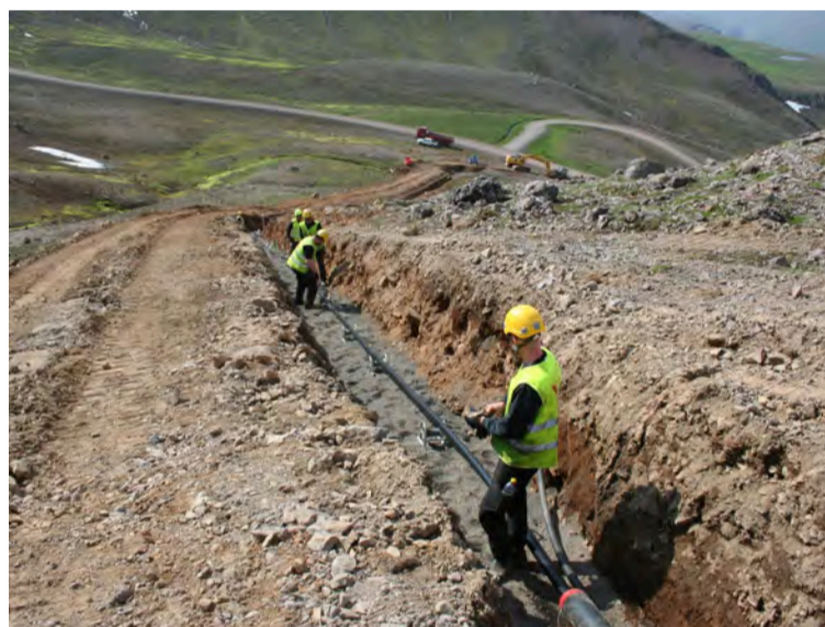
Unnið hefur verið við lagningu rúmlega 9 km 66 kV jarðstrengs yfir Hellisheiði eystri. Hér er verið að draga út streng í legg 5, sem er brattasti og erfiðasti leggurinn á strengleiðinni.
