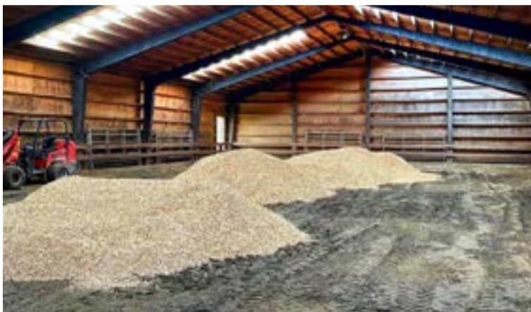
Unnið við að setja kurlíð á gólf reiðhallarinnar á Narfastöðum í Skagafirði.
