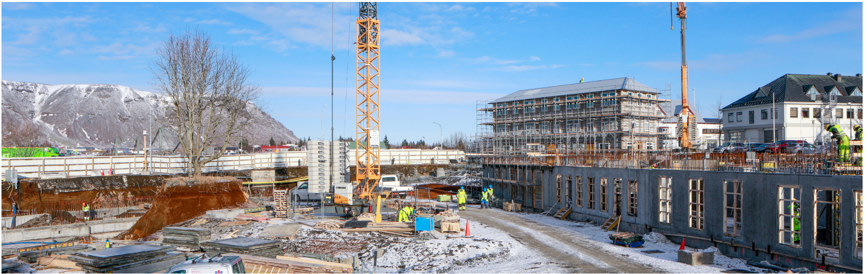
Horft yfir framkvæmdasvæðið af verðandi veitingatorgi. Til hægri er neðsta hæð fjögurra sambyggðra húsa þar sem verða veitingastaðir og til vinstri er unnið í grunni mjólkurbúshússins. Mynd: GPP
