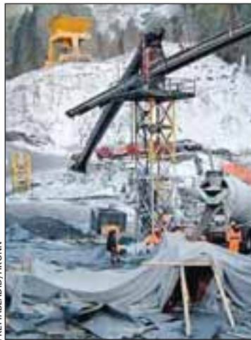
FRAMKVÆMDIR VIÐ KÁRAHNJÚKA Impregilo segist fara eftir samkomulagi við verkalýðshreyfinguna við frágang launa til portúgalskra starfsmanna og frábiður sér ásakanir um brot á samningum.
