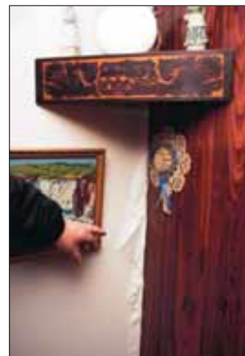
SPRUNGUR Í VEGGNUM Örn segir að hús sitt sé skakkt og skælt vegna framkvæmdanna.
