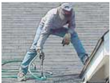
Gott er að skola þakrennuna með vatni.
