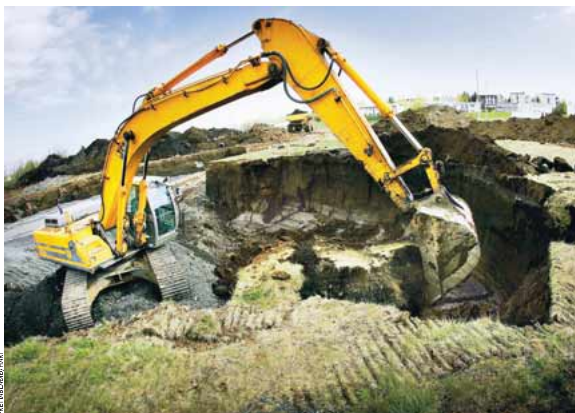
STÓRTÆKAR FRAMKVÆMDIR Framkvæmdir fara nú fram víða á höfuðborgarsvæðinu, enda fjólgar þeim yfirleitt með hækkanði sól. Þessi jarðyta var í undirbúningsvinnu í Mörkinni, þar sem verið er að grafa grunna. Fleiri voru í framkvæmdahug því að borgarstjórnarflokkur Sjálfstæðisflokksins kynnti hugmyndir sínar um vaxandi byggð og vegafarmkvæmdir í Reykjavík í gær.
