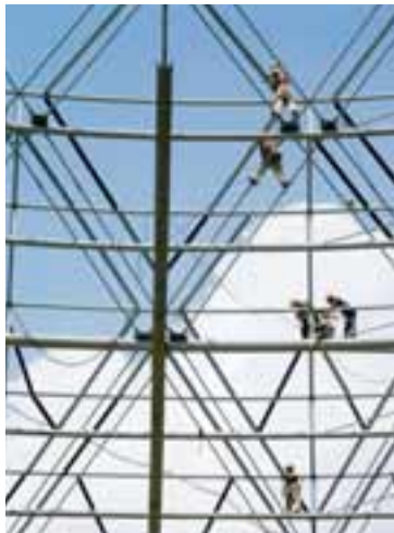
HEIMSINS STÆRSTA GLERÞAK Menn vinna að heimsins stærsta gegnsæja þaki, sem verður hluti af lestarstöð í Sjanghæ. Þakið er 278 metrar í þvermál.
