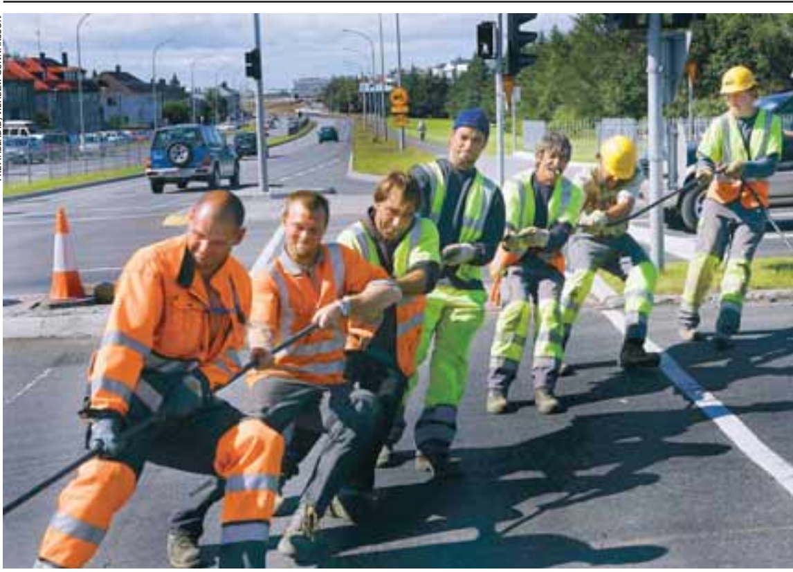
EIGA VIÐ RAMMAN REIP AÐ DRAGA Miklar framkvæmdir standa nú yfir við Miklubraut. Þessir filefdu vegavinnumenn nýttu tækifærið meðan grænt ljós var á gangandi vegfarendur við Lönguhlíð og drógu fjögur hundruð metra langan streng í gegnum rör sem liggur þangað frá gönguljósunum við gatnamót Stakkahlíðar og Miklubrautar.
