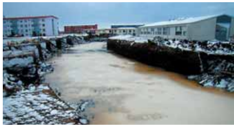
ÓGIRTUR HÚSGRUNNUR Eins og sjá má er um stóran og djúpan grunn að ræða. Hér sést leikskólinn Vallasel á hægri hönd.
