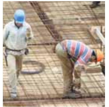
UNNIÐ VIÐ JÁRNABINDINGAR Erlendir verkamenn að störfum við járnabindingar. Myndin tengist ekki efni fréttarinnar.
