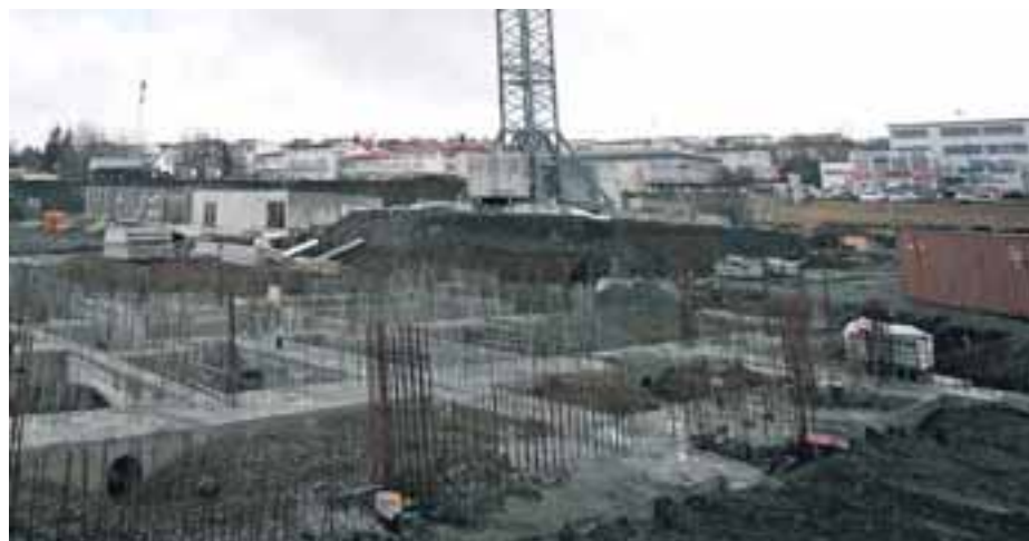
Frá steypuvinnunni sem nú er nýhafin í Lundarhverfi. Í baksýn er Nýbýlavegur.
