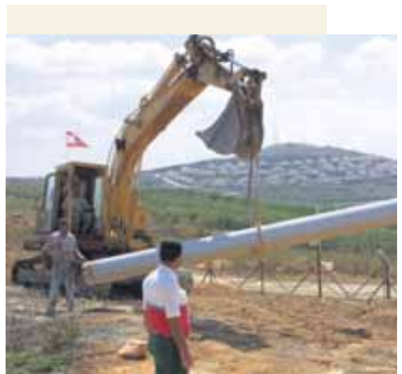
VATNSVEITULAGNING Vatn er án nokkurs efa einn mikilvægasti þátturinn til að viðhalda lífi á jörðinni. Á myndinni er unnið að lagningu vatnsleiðslu við á í suðurhluta Líbanons sem liggur við landamæri Ísraels. Oft hefur kastast í kekki á milli landanna vegna vatnsveitunnar. Fréttablaðið/AFP
