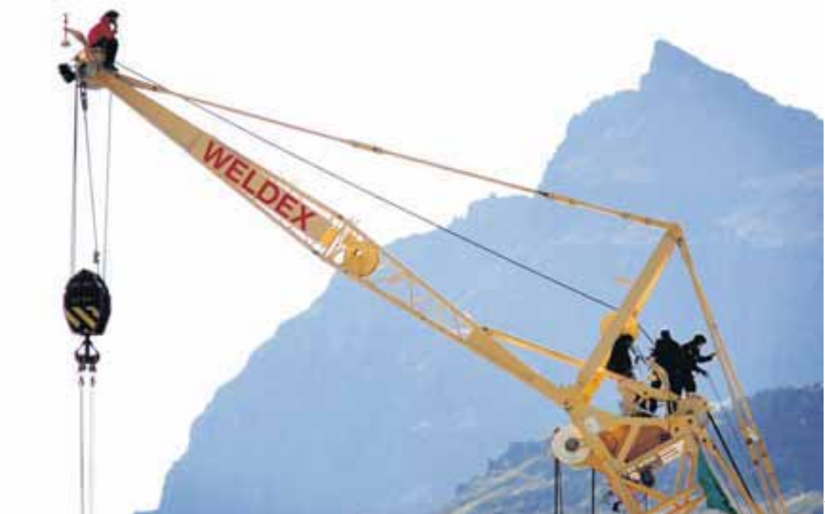
MÓTMÆLI Á REYÐARFIRÐI Þrjú lögglumenn eru hér komnir upp á krana á byggingarsvæði álvers Alcoa á Reyðarfirði og hyggjast færa mótmælenda niður sem situr í mestu rölegheitum eftir í krananum. Alls voru 14 manns handteknir vegna mótmælanna í gærmorgun og fengu þeir að gista fangageymslur lögglunnar í nótt. Sjá síðu 4
