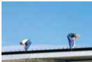
UNNIÐ Í BLÍÐUNNI Unnið var við framkvæmdir í góða veðrinu í gær. FRÉTTABLAÐIÐ/ANTON
