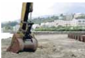
Framkvæmdir standa nú yfir á mótum Strand- og Glerárgötu í miðbæ Akureyrar þar sem nýja menningarhúsið mun rísa.
