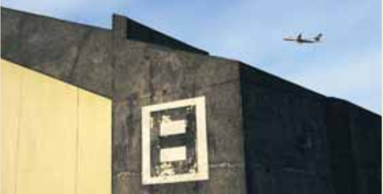
VEÐRUÐ VARNARSTEYPA Íslenskt veðurfar hefur sett mark sitt á sprengjuhelda steypu orrustuþotuflugskýlanna á Keflavíkurflugvelli. Flugleiðarþota í flugtaki í baksýn.
