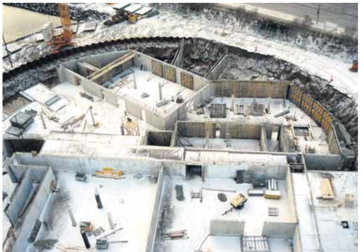
Menningarhúsið á Akureyri er óðum að taka á sig mynd en verkið er á áætlun.
