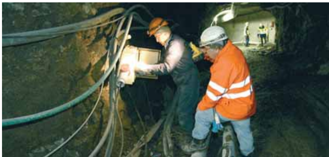
STARFSMENN Í GÖNGUM Á KÁRAHNJÚKUM Talið er að snefilefni úr fjölmörgum dísilvélum í göngunum séu meginorsök loftmengunarinnar, sem fjöldi starfsmanna hefur orðið fyrir barðinu á undanfarið.
