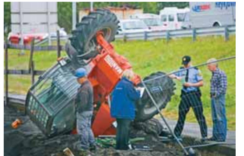
ALLT Á HVOLFI Verkamenn og lögregla stumra yfir skotbómulyftara sem fór á hvolf við Valsheimilið um tvöleitið í gær. Lyftarinn var að hifa upp steypuklumpa og ætlunin var að færa þá til. Eitt dekki fór út fyrir kantinn og féll þá lyftarinn ofan í grunninn. Ökumaðurinn slapp ómeiddur.
