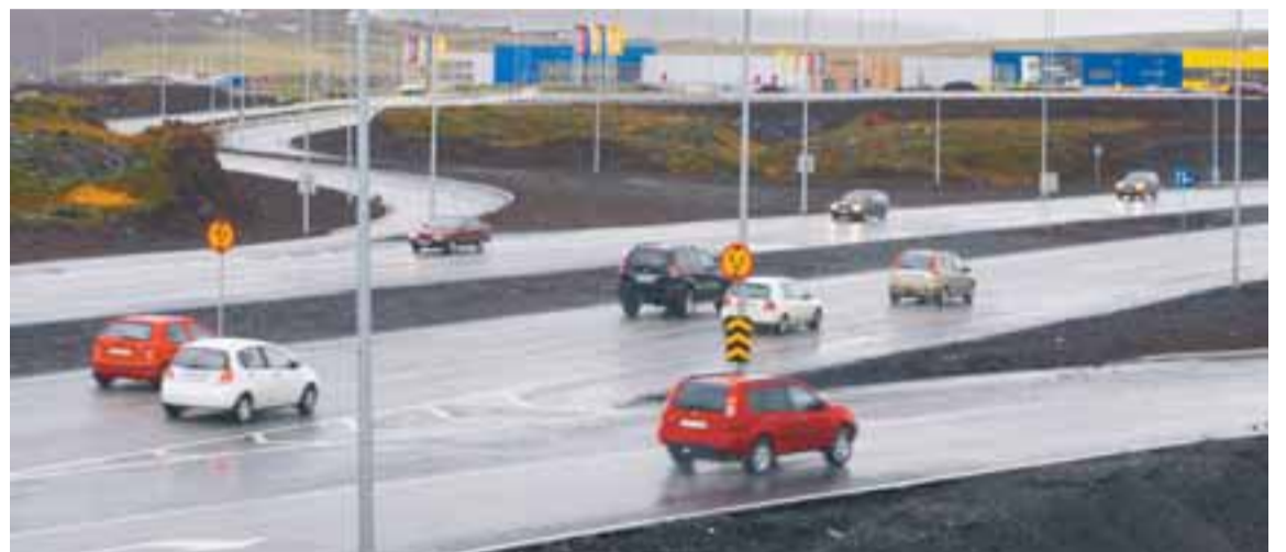
FRAMKVÆMDUM HEFUR SEINKAÐ Framkvæmdum við breikkun Reykjanesbrautar í Garðabæ hefur seinkað verulega og er fyrir sjáanlegt að þeim ljúki ekki fyrr en í fyrsta lagi rétt undir jól. Ýmis frágangur er eftir, til dæmis við veglýsingu og hitaveitulagnir.
