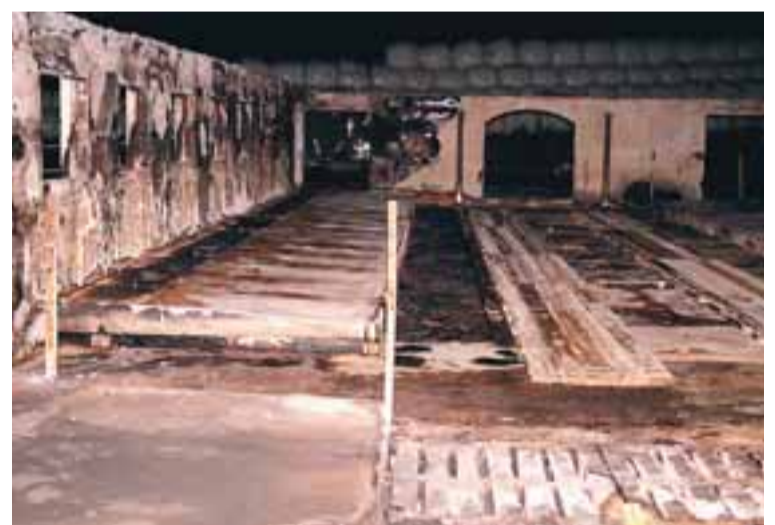
BRUNARÚSTIR EINAR Fjósið og byggingar sem því fylgdu voru um 1.100 fermetrar, en eldurinn skildi eftir svartar rústir. Nýja fjósið sem reist verður í næsta mánuði verður 450 fermetrar.
