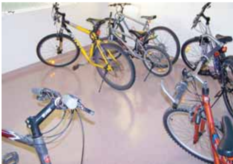
Topp 4000 hentar vel á álagsfleti í fjölbýlishúsum og bílskúrum, en hér sést hvernig það er lagt samskeytalaust með húlki upp á vegg í hjólageymslu.
