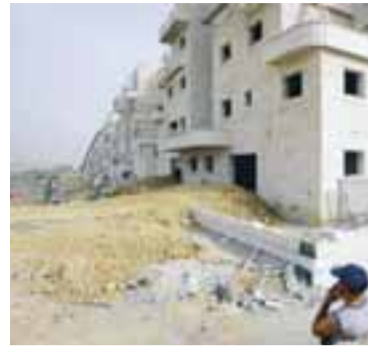
BYGGT Í GIVAT ZEEV í byggð landtökumanna á Vesturbakkanum skammt frá Jerúsalem rísa þessar nýju byggingar.
