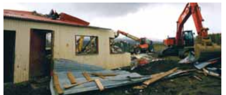
TRUNTUBAKKAR Átta hesthús voru reist á lóð sem úthlutað var til bráðabirgða árið 1970. Þau hús sem ekki voru færð fyrir miðjan maí 2007 voru rifin. MYND/AUSTURGLUGGINN
