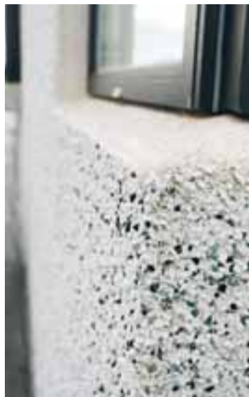
Steining getur enst áratugum saman ef vandað er til verks en Múr og mál hafa endursteynað hús sem byggð voru 1930.
