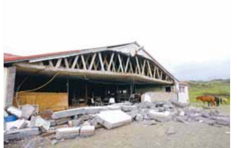
SKEMMDIR Á HÚSUM Mörg hús skemmdust illa í jarðskjálftunum 29. maí síðastliðinn. Hafa sum þeirra þegar verið úrskurðað ónýtt en önnur stendur til að endurbyggja eða laga. FRÉTTABLAÐIÐ/STEFÁN
