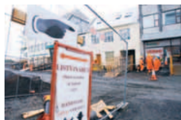
KRAMBÚÐIN Framkvæmdirnar hafa haft gríðarleg áhrif á viðskiptin og starfsfólk vinnur minna.
