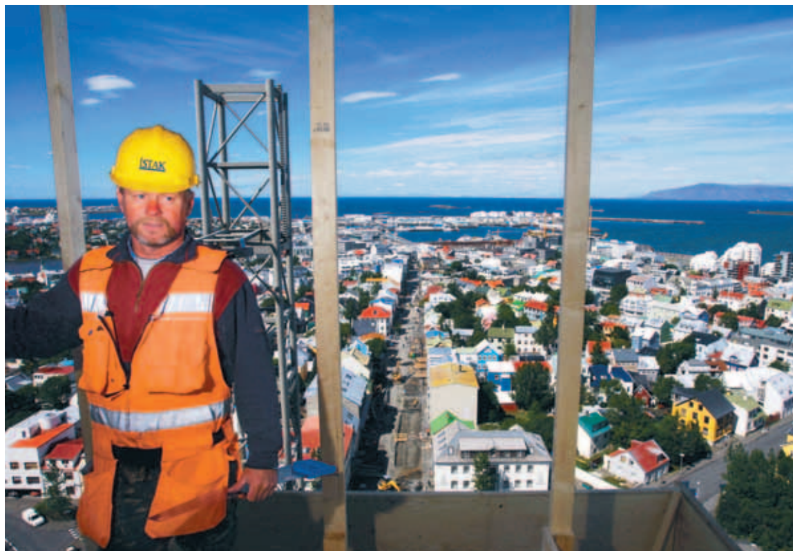
ÚRVALS ÚTSÝNI Um tuttugu starfsmenn Ístaks hafa síðan í vor unnið við viðgerðir á turni Hallgrímskirkju. Turninn, sem er 75 metra hár, var illa farinn af steypuskemmdum og er verkið með viðameiri viðgerðarframkvæmdum sem ráðist hefur verið í hér á landi. Verkið hefur gengið vel, enda veðurskilyrði góð upp á síðkastið. Áætlað er að verkið taki um það bil eitt ár.
