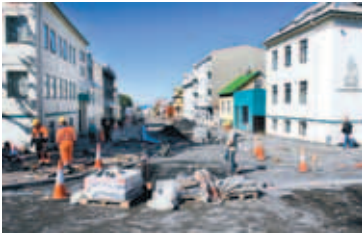
SKÓLAVÖRÐUSTÍGUR Verktakar vinna hörðum höndum við að klára framkvæmdir á Skólavörðustíg fyrir opunarhátíðina á laugardag. FRÉTTABLAÐIÐ/GVA
