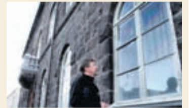
ALÞINGISHÚSIÐ ILLA LEIKIÐ Ólafur Kristjánsson, starfsmaður HBH, tók út skemmdir á Alþingishúsinu en sérstarkt gler er í húsinu sem talið er hafa varnað því að húsið skemmdist verr en ella.
