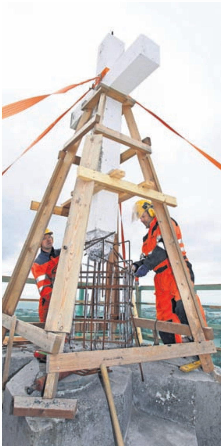
VIÐ KROSSINN Nú er rétt ár síðan vinnupallar tóku að skríða upp eftir veggjum Hallgrímskirkju vegna umfangsmikilla viðgerða. Starfsmenn Ístaks unnu í gær að viðgerðum á krossi kirkjunnar sem er höfuðjásn kirkjunnar í rúmlega sjötíu metra hæð. Viðgerð á kirkjunni á að ljúka á haustmánuðum.
