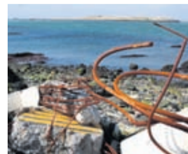
SÉÐ TIL VIÐEYJAR Útsýnið frá fjörunni er í gegn um járnarusl og steypubrot.
