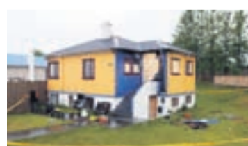
HÚSIÐ Á KLEPPSVEGI Einbýlishúsið sem brann á Kleppsvegi er talið nánast ónytt eftir eldsvoðann. FRÉTTABLAÐIÐ/VILHELM
