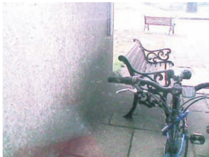
MÝVATNSSVEIT Þessi veggur er í raun hvítur. Sönn saga.
