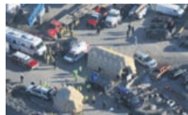
MIKIL SPRENGING Orkuverið var enn í byggingu þegar sprengingin varð.
