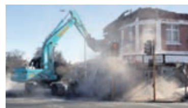
ENDURREISN Yfirvöld í Christchurch hafa þegar látið rífa hús sem hættu þótt stafa af vegna skemmda.
