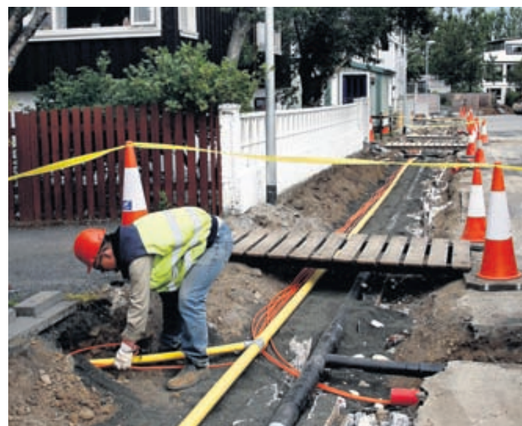
LJÓSLEIÐARI LAGÐUR Deilur vegna ljósleiðaralagningar á vegum Orkuveitu Reykjavíkur náðu hámarki á fyrri hluta þessa áratugar þegar verkefnið var undir hattí Línu.
