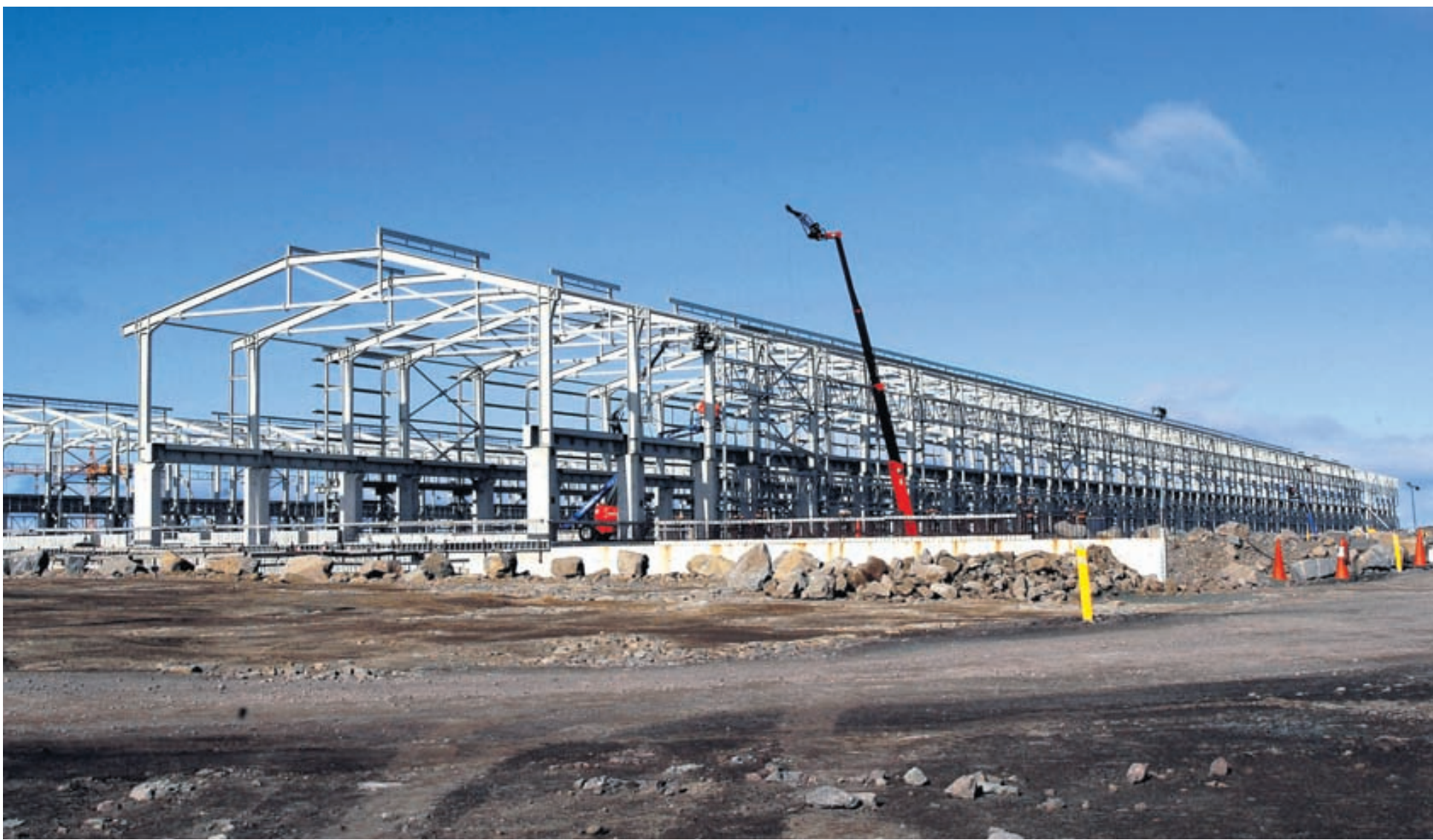
Í HELGUVÍK Þaksperrur fyrirhugaðs kerskála álversins eru komnar upp en líklega verður enn bið á framkvæmdum þar til orkumál eru útkljáð.
