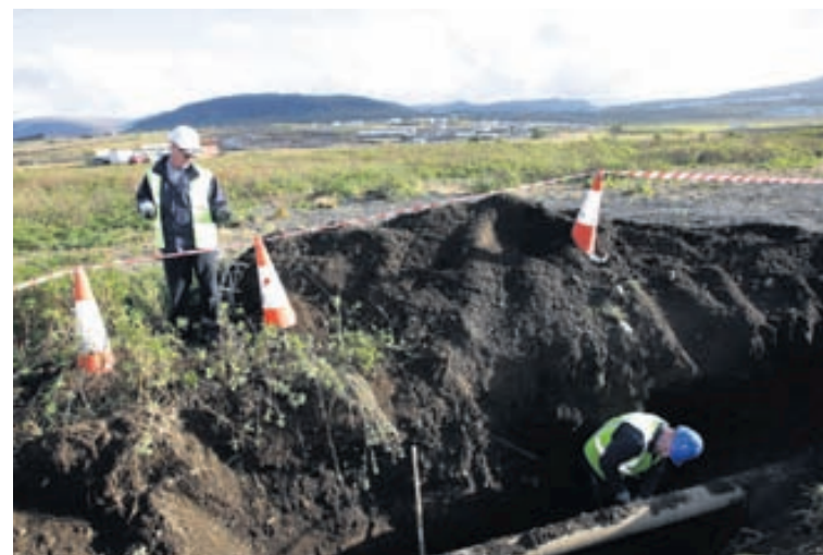
STARFSMENN ORKUVEITUNNAR Utan við landamerki Perluhvamms fannst heimæð fyrir kalt vatn að húsinu og var hún aftengd.
