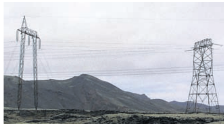
TVEGGJA TURNA TAL Hér getur að líta háspennumöstur á Hellsisheiði, austan við virkjun Orkuveitu Reykjavíkur.
