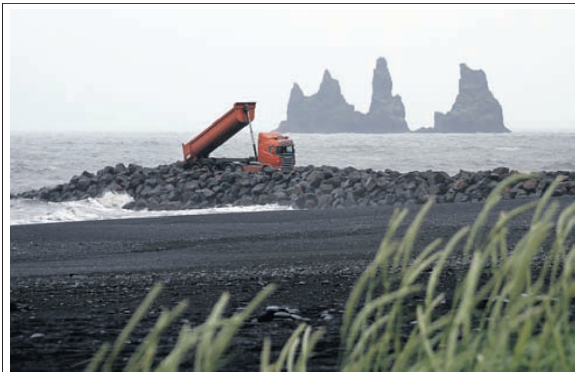
SANDFANGARI RÍS Í VÍKURFJÖRU Verktakafélagið Glaumur annast framkvæmdina. Halldór Ingólfsson framkvæmdastjóri segir að þegar hafi safnast sandur við átta tíu metra af garðinum. Framkvæmdin kostar 120 milljónir. Verklök eru í lok september.
