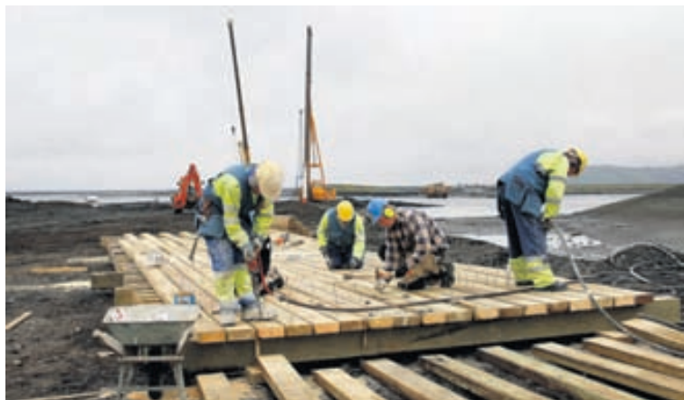
BRÚARSMÍÐ Búið var að smíða helming brúargólfsins í gærkvöldi og höfðu starfsmenn hafist handa við að setja það á stálbita.
