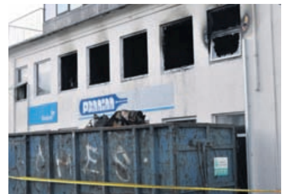
MIKIÐ TJÓN Byggingin sem hýsti Pennann og hótelið skemmdist mikið í brunanum.
