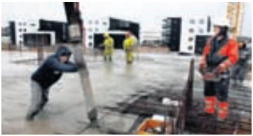
STEYPA Framleiðsla á steinsteypu losar um 3 milljarða tonna af koltvísýringi á heimsvísu á ári.
